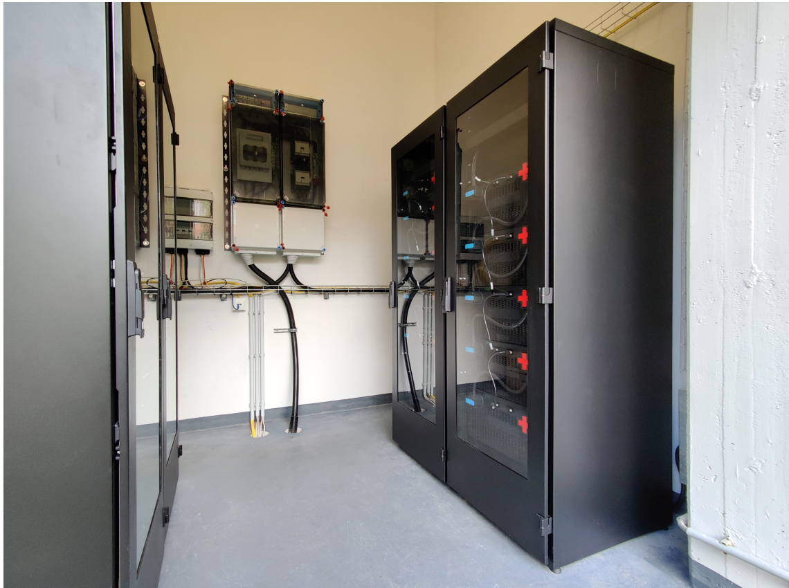
Abbildung 3.2: Batteriespeichersystem im Transformatorraum
